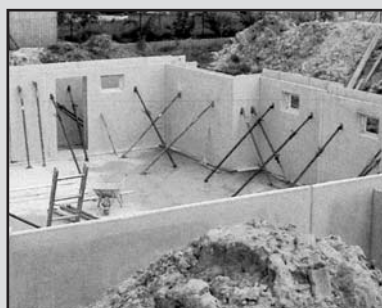
Unzählige Stützen erschweren den weiteren Baufortschritt.
