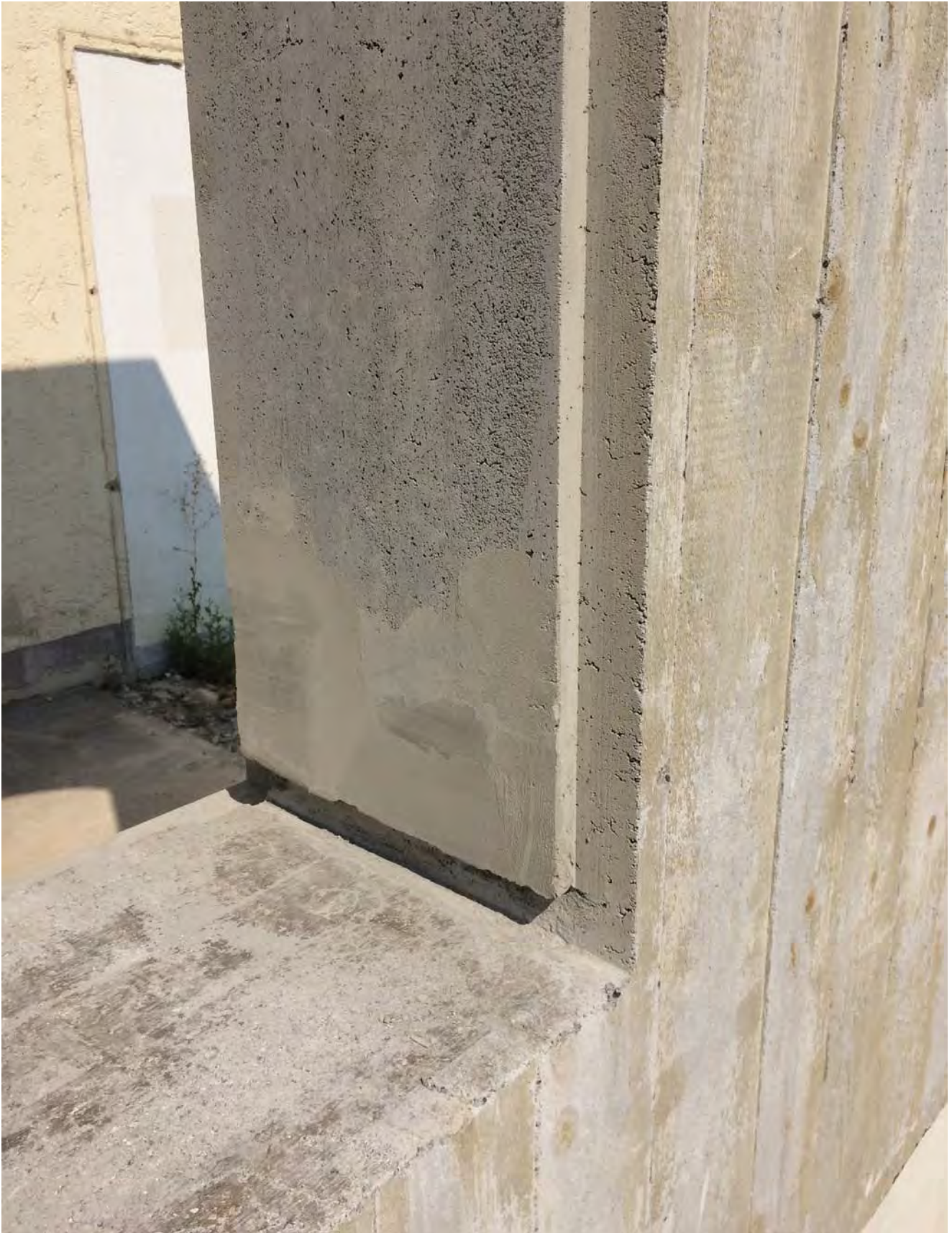
Im Bereich der Aussparungen zur Überdeckung des Fensterblechs kam es beim Ausschalen zu Ausbrüchen, die ausgebessert werden mussten.
