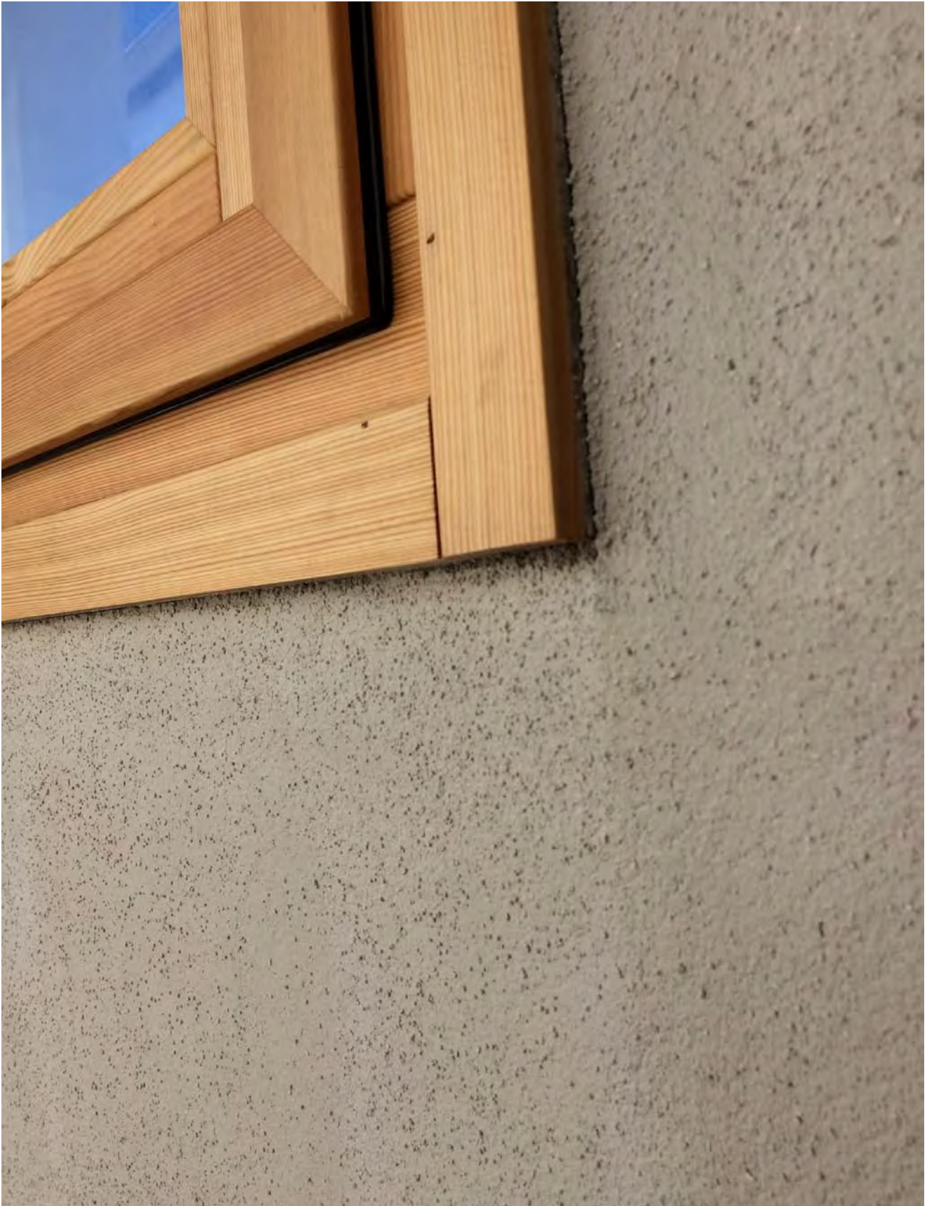
Gefitzte Wandschlämme auf der Innenseite der Mauerwerkswand
