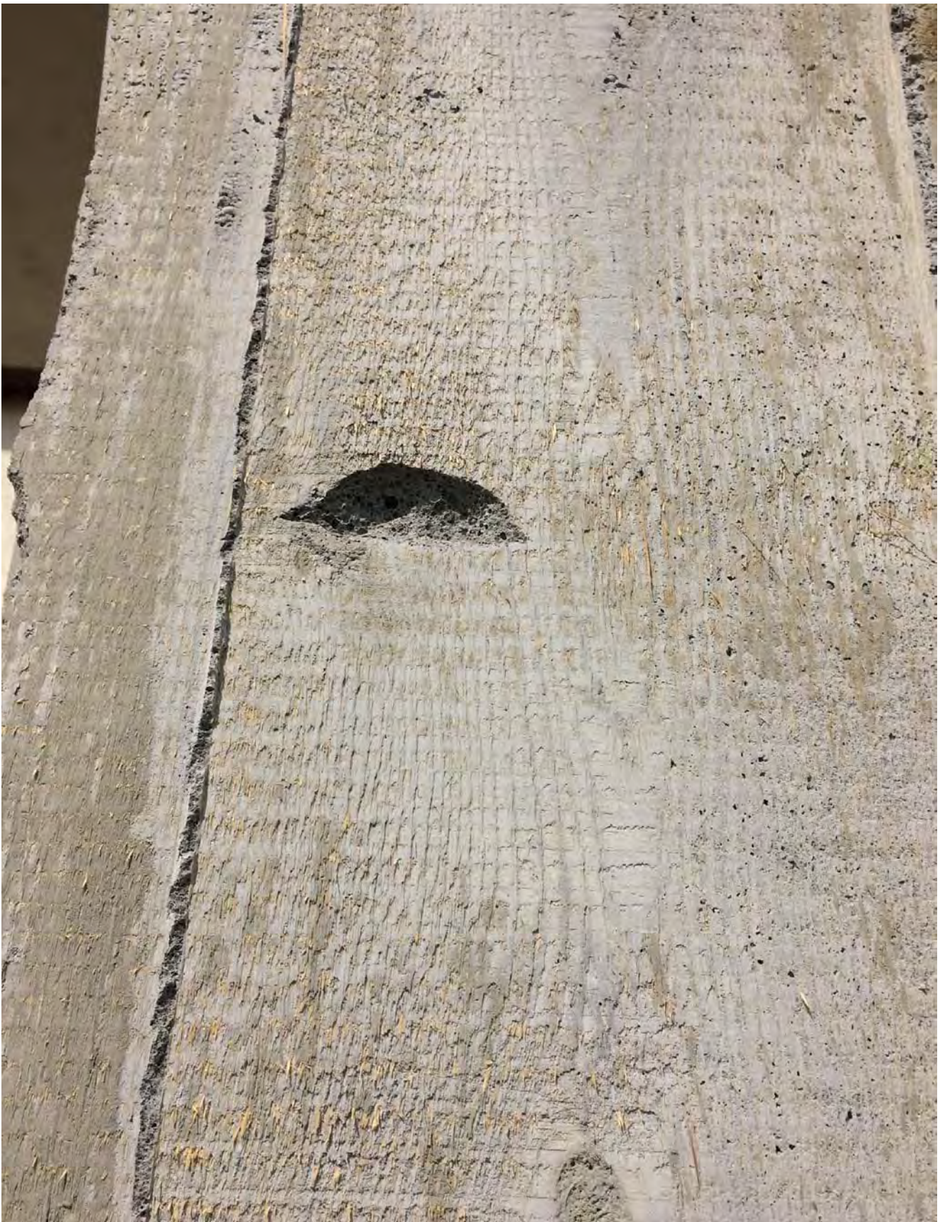
An Astlöchern in der sägerauhen Schalung kam es zu Ausbrüchen des Leichtbetons beim Ausschalen, vermutlich durch Verklebungen.
