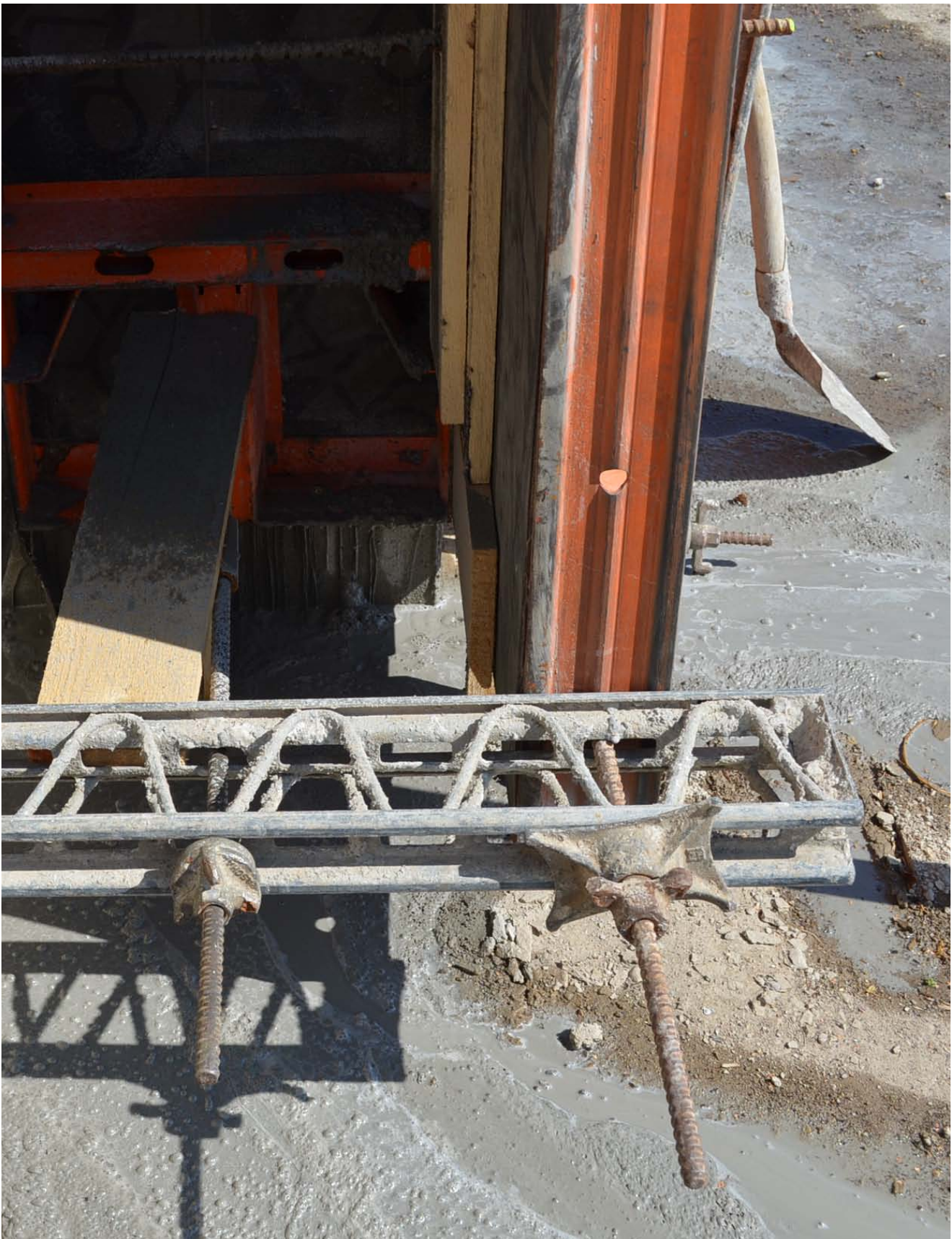
Im Bereich der Schalungsfugen trat während des Betoniervorgangs eine größere Menge Betonmilch aus
