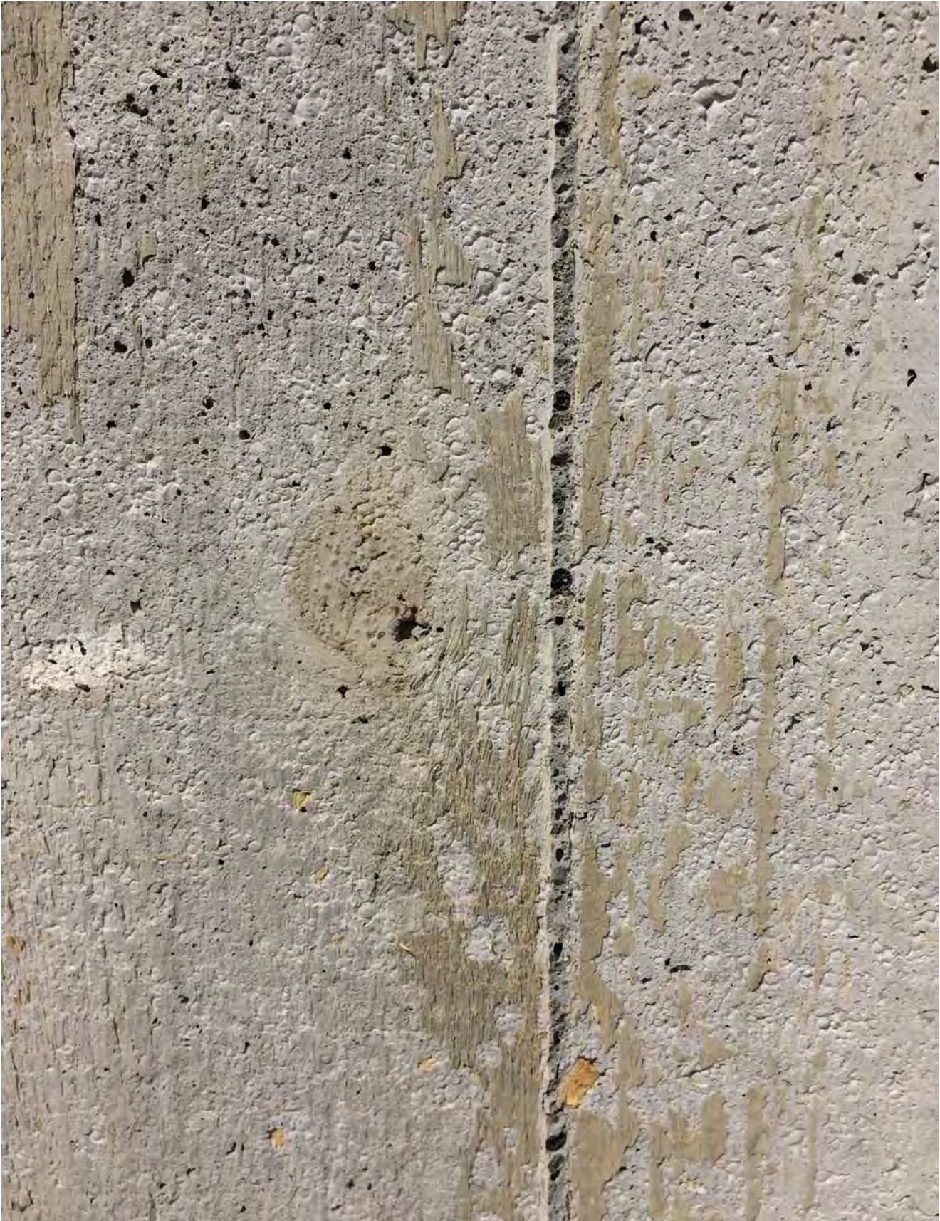
Die Zementschlämme auf den sägerauhen Brettern ist beim Ausschalen teilweise an der Betonoberfläche haften geblieben.
