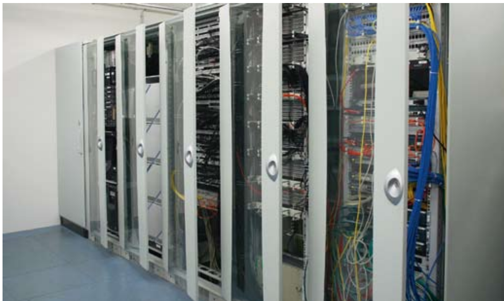
Der Serverraum der „Villa Kennedy“, in dem die gesamte EDV und die Beschallungsanlage untergebracht ist, wurde mit einer Speziallöschanlage ausgestattet
