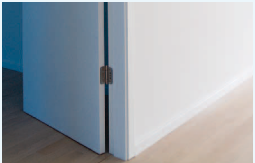
Schwach auf der Brust: Vergleichsweise leichte Türblätter und konstruktionsbedingte Bodenfugen – z.B. wegen durchgehender Bodenbeläge – beeinträchtigen zumeist den Schallschutz der Trennwände erheblich.
