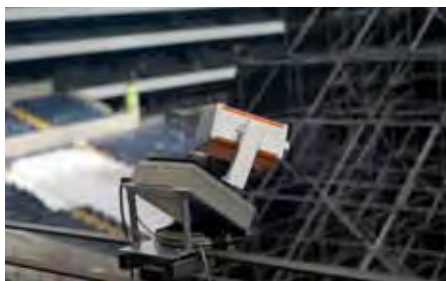
Das „Pyrosmart-System“ scannt laufend die gesamte Rückseite der Videoleinwand ab.
