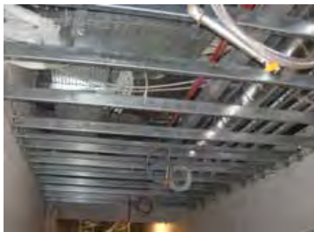
Richtig – Um das Herabfallen von Leitungen auf die Unterdecke im Brandfall sicher zu verhindern, müssen Abstände korrekt berechnet und eingehalten werden.
