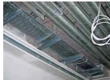
Richtige Installation im Zwischendeckenbereich – Brandgeprüfte Konsolen, die am freien Ende zudem von Gewindestangen gehalten werden (F 90 Prüfung liegt vor).
