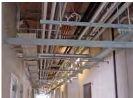
Falsch – Die vordere Schiene ist zu lang (maximal 700 mm nach Brandprüfung), die Gewindestange sitzt zu weit innen, das freie Ende ist demzufolge nicht mehr geprüft.
