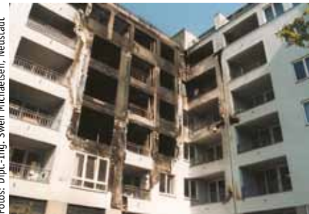
Beispiel für einen Brand an einer gedämmten Fassade.
