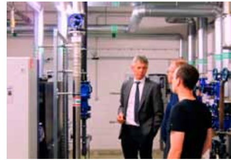
Thomas Schmitt, stellv. Geschäftsführer bei der Dornhöfer GmbH Automation & Haustechnik (li.), beantwortet die Fragen des technischen Betriebspersonals zur installierten Feuerlösch-Trennstation.
