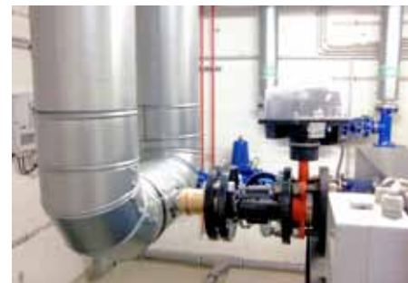
Ein Magnetventil steuert die Trinkwassereinspeisung zum Löschwasserbehälter. Nach den geltenden Regelwerken darf die Länge der Trinkwasseranschlussleitung an Geräte ohne ständige Wasserentnahme maximal dem zehnfachen Rohrdurchmesser entsprechen. Um diese Vorgabe zu erfüllen, wurde die Anbindeleitung durchströmt ausgeführt.
