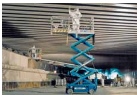
Hafenstraßenunterführung im Hauptbahnhof Frankfurt am Main: Einbau der Brandschutzbeschichtung auf die Brückenunterseite.
