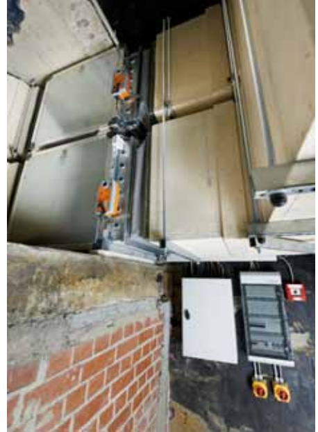
Bei elektronisch geregelten Differenzdruckanlagen erzeugen Ventilatoren mit modifiziertem EC-Motor exakt den geforderten Überdruck im Treppenhaus. Weil auf Regelklappen im oberen Bereich des Treppenhauses verzichtet werden kann, eignen sich elektronische Systeme auch für die Nachrüstung.
