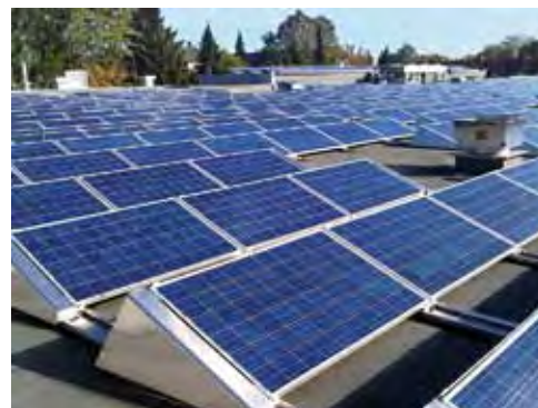
Gerade großflächige Dächer eignen sich hervorragend als Standort für Solaranlagen
