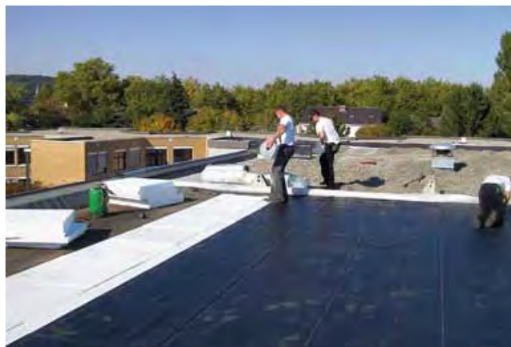
Lose Verlegung der Dachabdichtung (im Hintergrund die Kiesschicht)
